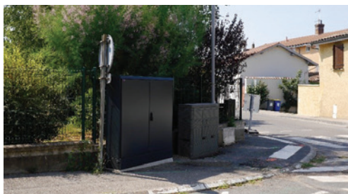
Armoire angle route de Chasselay, chemin Saint-Laurent
