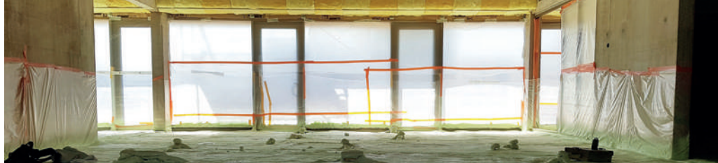
Couverture des serpentins du chauffage
